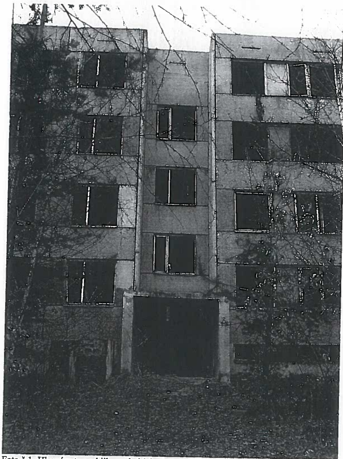
Foto č.1- Hlavní vstup od jihu – chybí dveře
