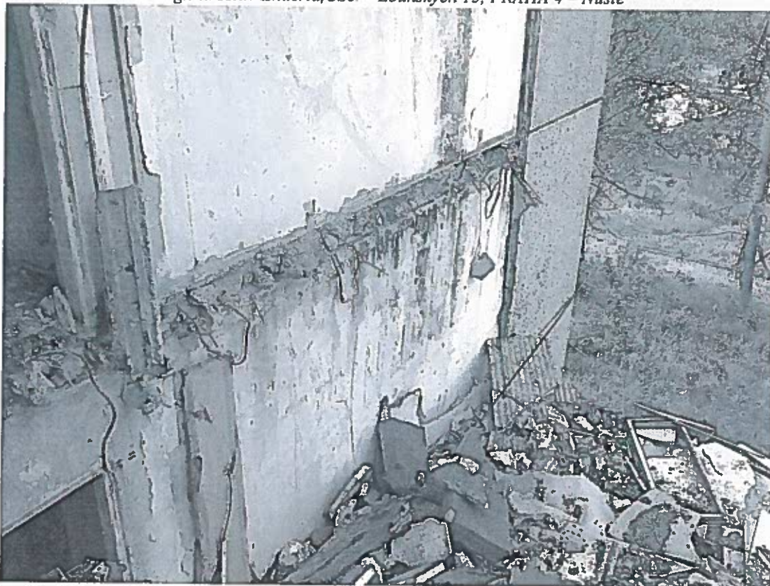
Foto č.10 – Nosná stěna je propojena v úrovni stropní desky se stěnou lodžiovou ocelovým „I“ nosníkem, stykovací betonářská výztuž je vytržena
