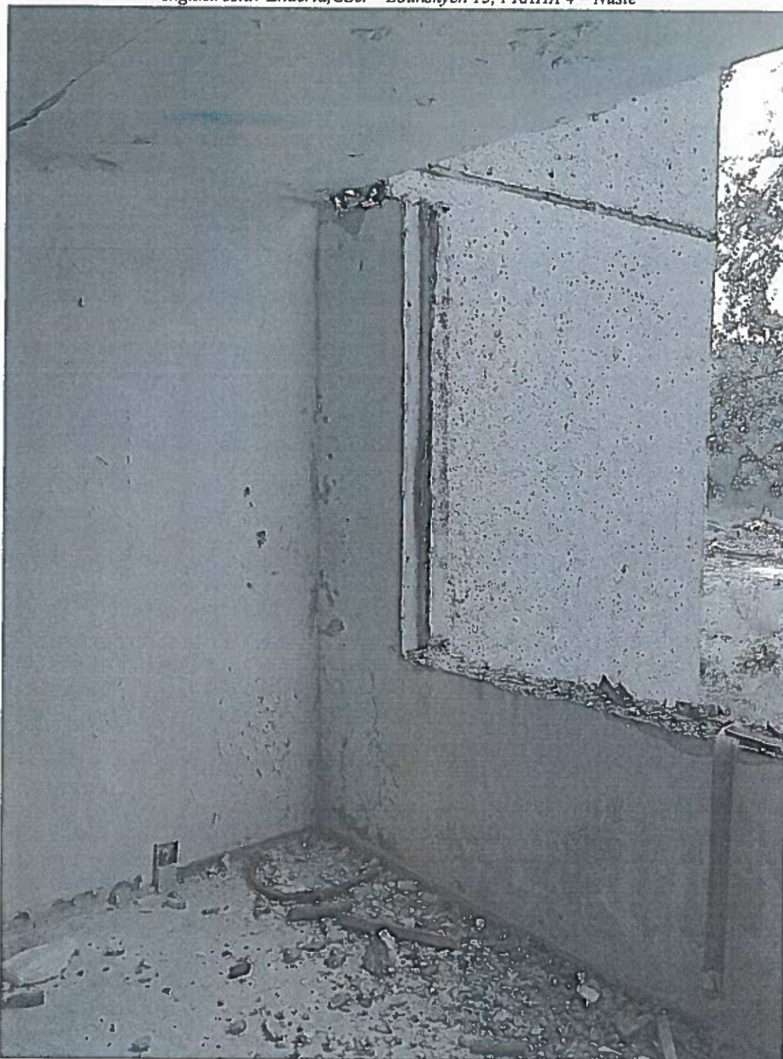
Foto č.7- Fasádní stěna v 2.NP zůstala nepoškozena
