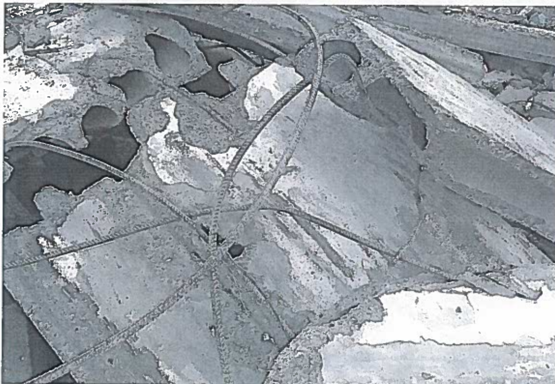
Foto č.6 – Snesené stropní dílce jsou zcela zničeny
